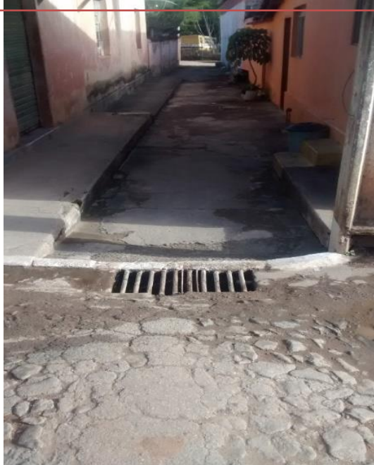
Figura 107 Boca de lobo fora em desacordo com as especificações técnicas.
