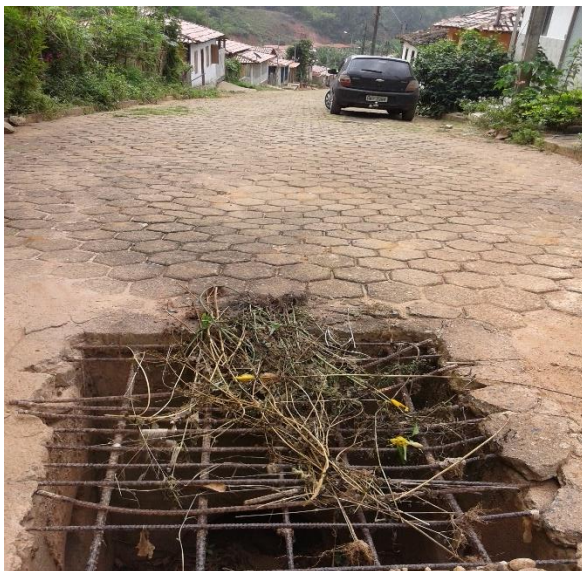
Figura 105. Tampa de PV danificada.
