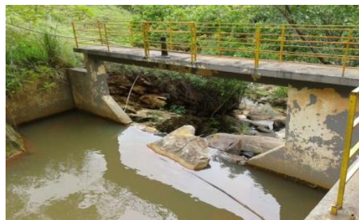
Figura 19. Barragem de captação.
