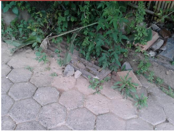
Figura 101. Ausência de manutenção.
