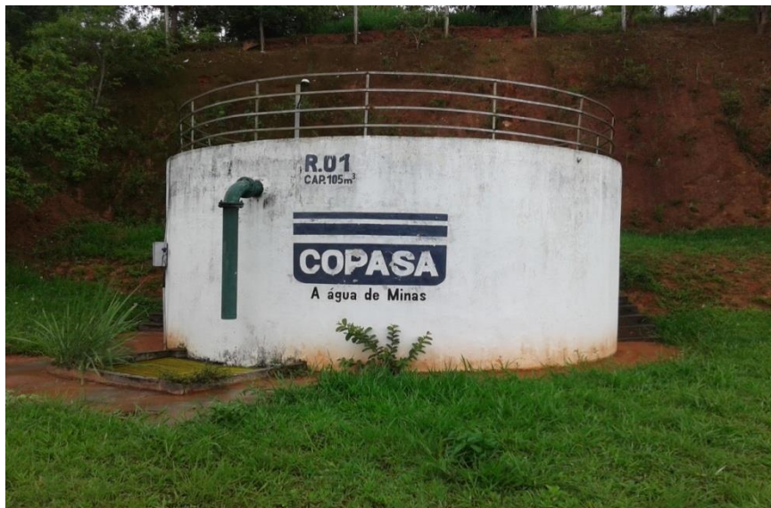
Figura 33. Reservatório da sede, 105m 3 .
