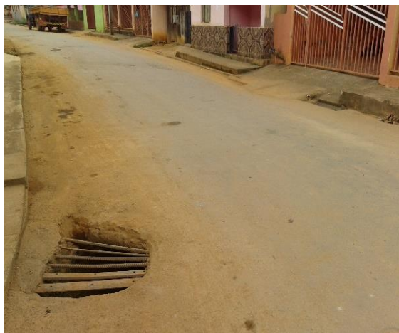
Figura 109. Estrutura em desacordo com as normas técnicas.
