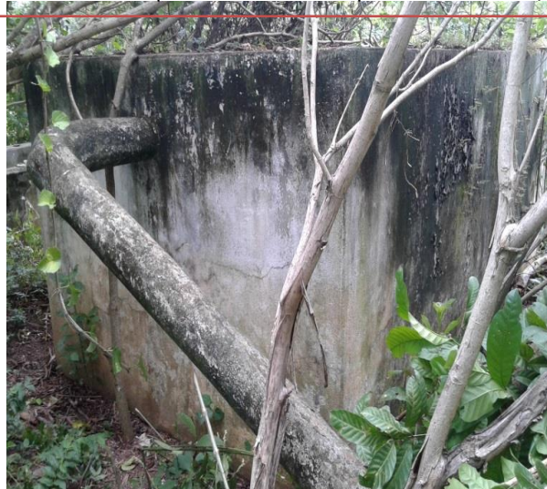
Figura 56: ETE 03 Inoperante e em total estado de abandono.
