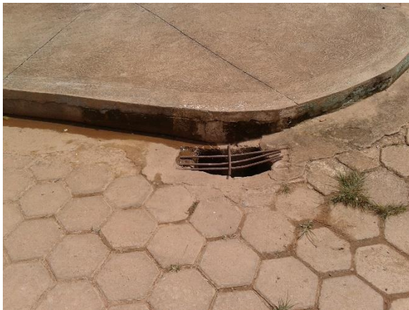
Figura 103. Estrutura em desacordo com as normas técnicas.
