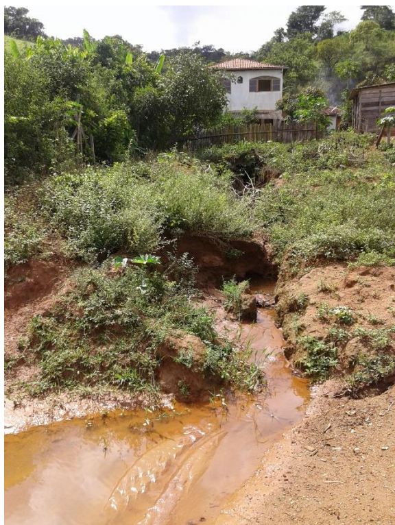
Figura 113. Erosão em ponto de lançamento devido a ausência de estrutura de drenagem.
