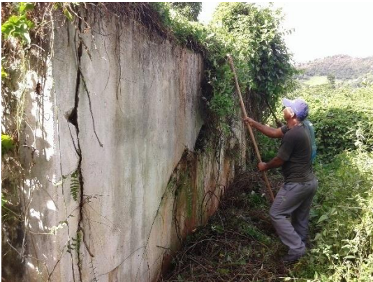
Figura 53. Unidade com danos estruturais. (ETE 02).
