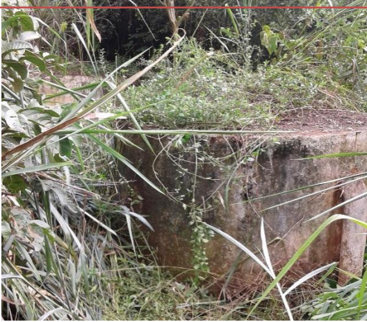
Figura 49: ETE 01 inoperante e em estado de total abandono.
