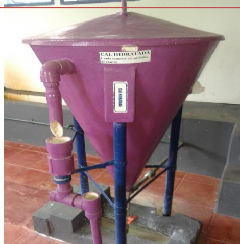
Figura 27. Dosador de produtos químicos.
