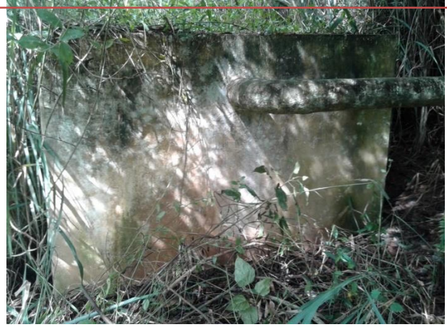
Figura 50 ETE 01 inoperante e em estado de total abandono.
