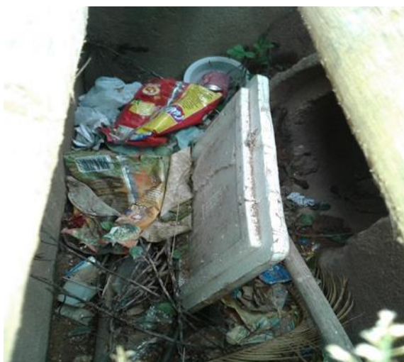
Figura 100 Falta de manutenção do sistema e presença de sólidos grosseiros obstruindo galerias.
