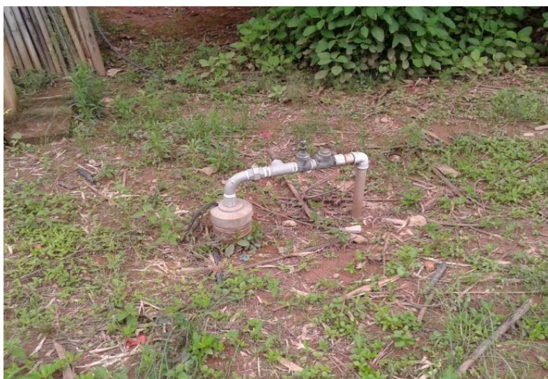
Figura 39 Captação de água subterrânea para distribuição na comunidade, localizado sob as coordenadas 18°15'40.0"S 42°42'58.3"W .
