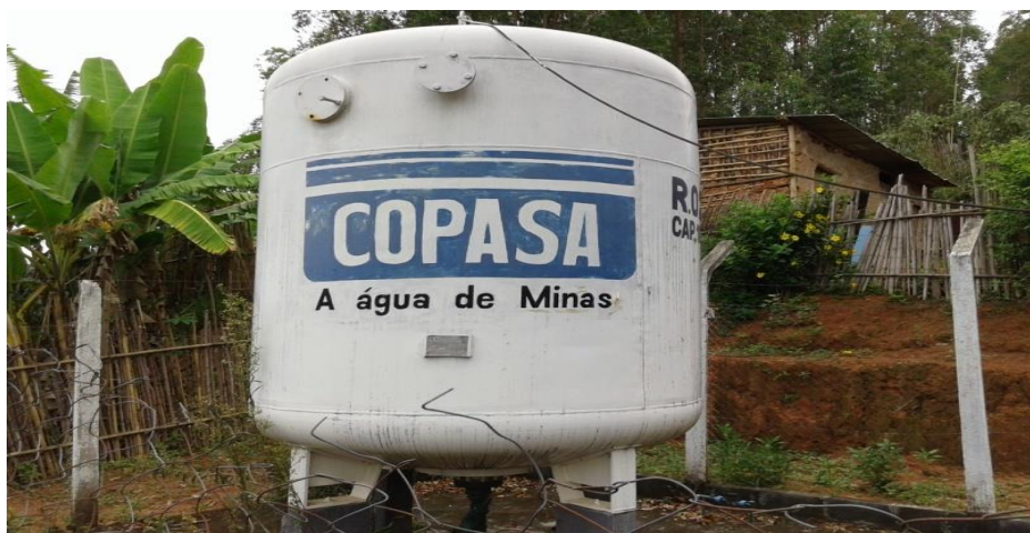
Figura 34 Reservatório da sede, 10m 3 .
