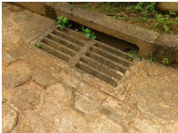
Figura 95. Boca de lobo.
