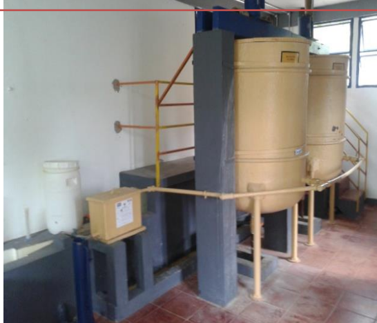
Figura 26 Dosador de produtos químicos.
