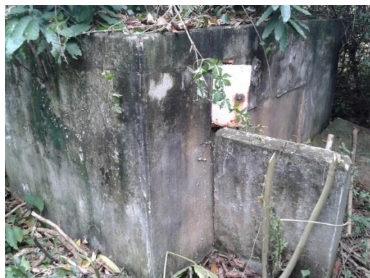
Figura 58: ETE 03 Inoperante e em total estado de abandono.
