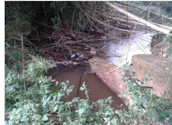
Figura 54. Lançamento dos efluentes diretamente no curso de água (ETE 02).
