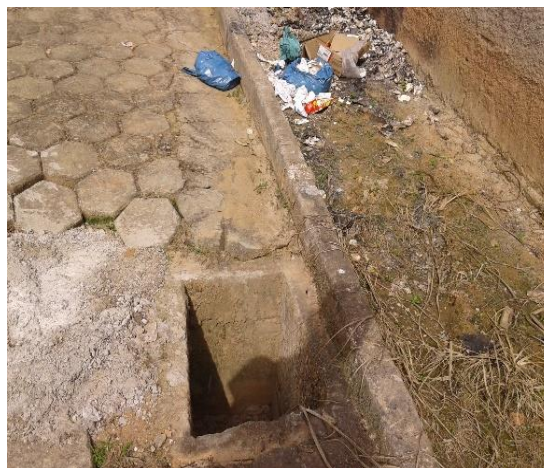
Figura 110. Boca de lobo sem grelha.
