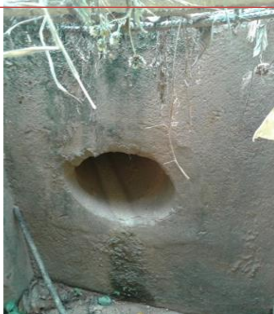
Figura 108. Tubos de coleta.
