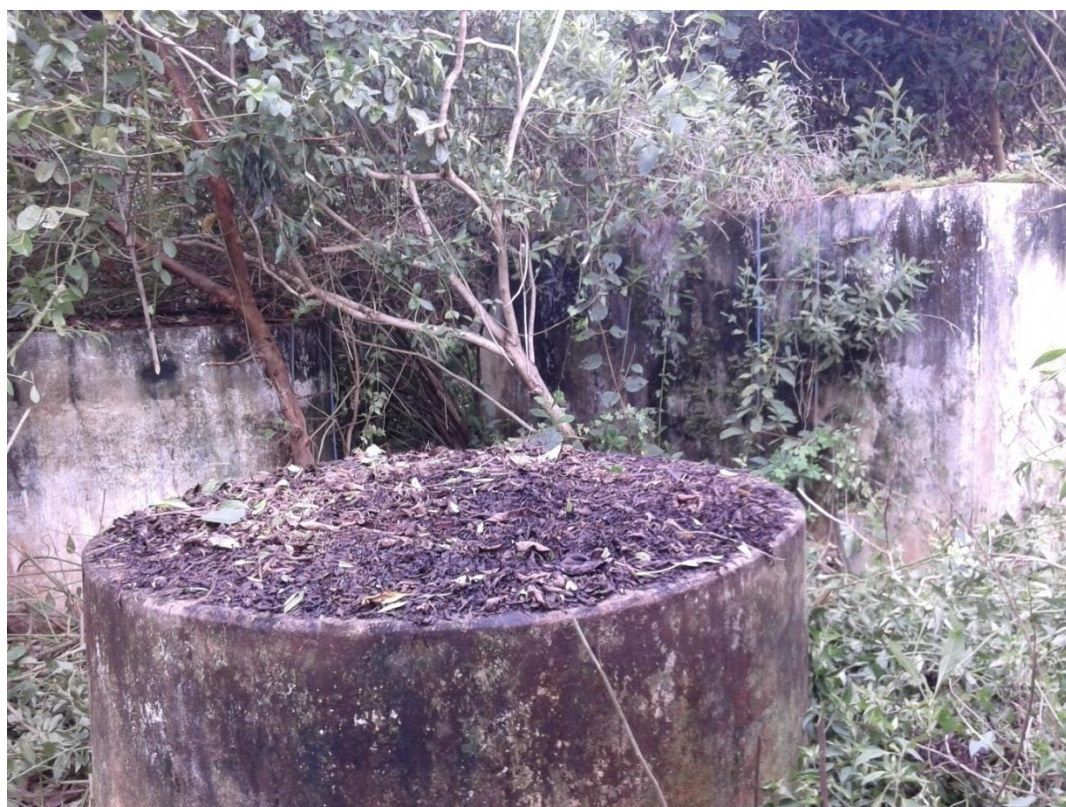
Figura 48: ETE 01 inoperante e em estado de completo abandono
