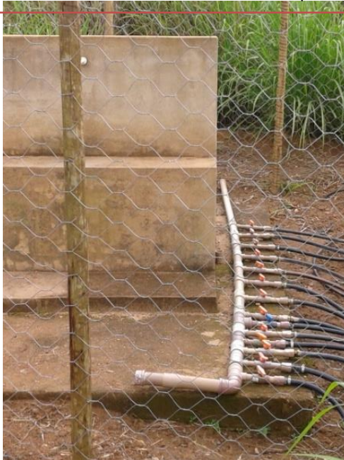
Figura 40 Distribuição de água na comunidade Santa Cruz.
