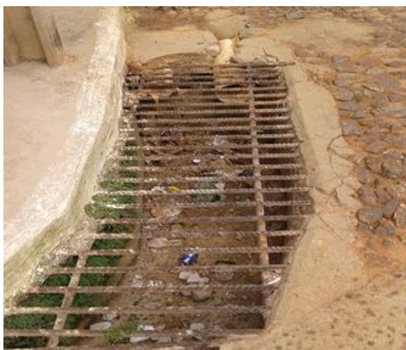
Figura 99. Estrutura em desacordo com as normas técnicas.
