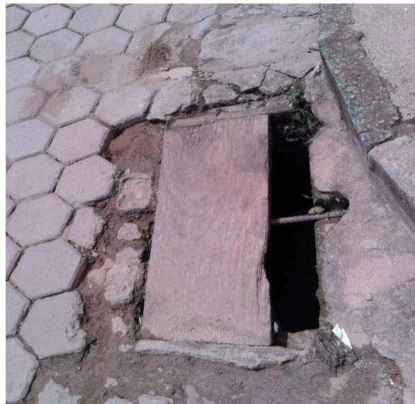
Figura 106 Boca de lobo danificada.
