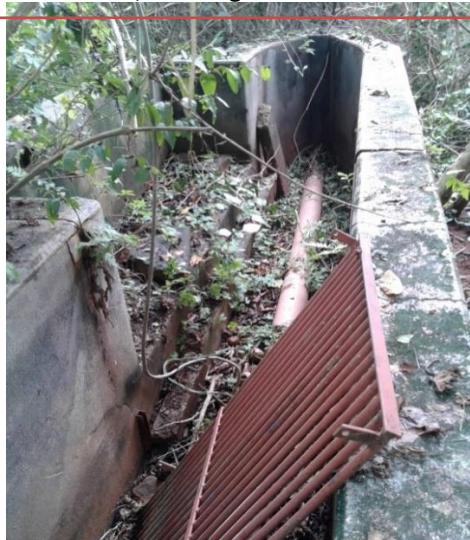
Figura 55: ETE 03 Inoperante e em total estado de abandono.
